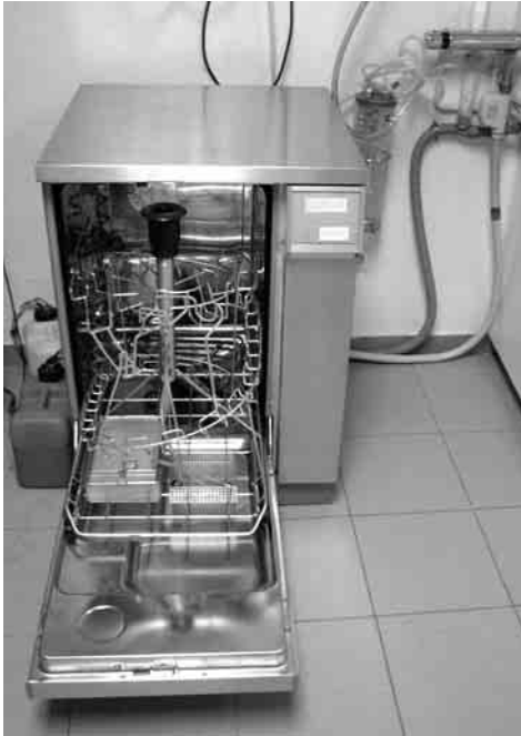
FIGURA 4. Lavadora automática y conexiones.
